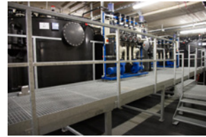
Abklinganlage, die sich im Keller unterhalb der Therapiestation befindet und in der die Abwässer gesammelt werden.
